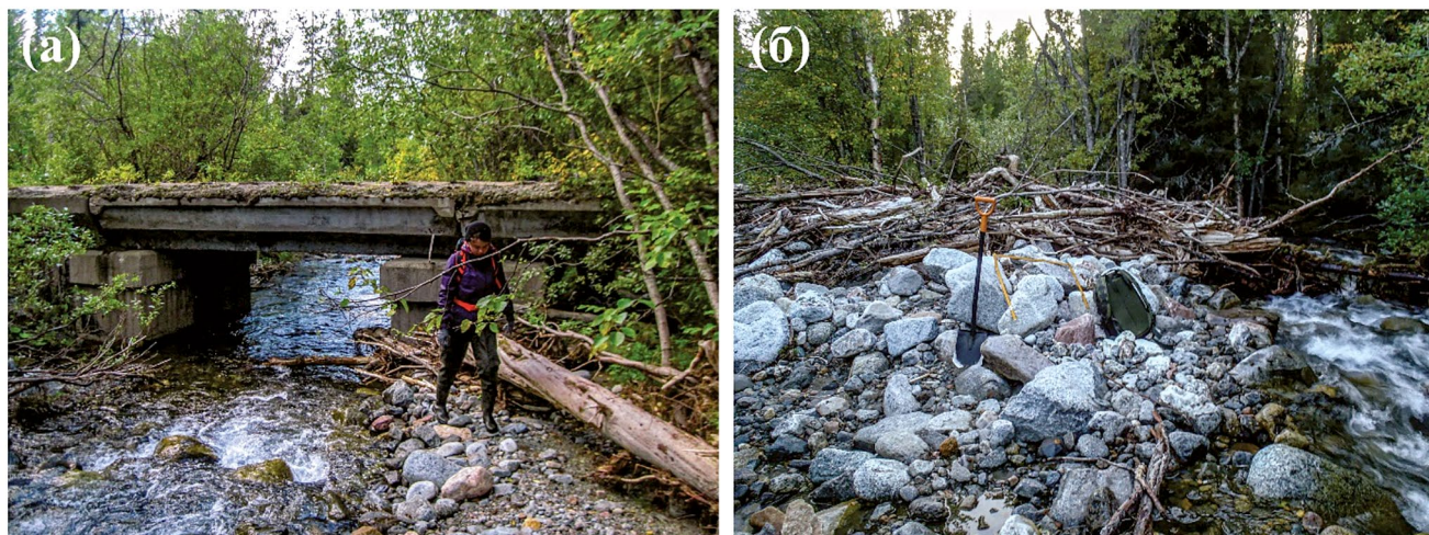
Рис. 6. Расчетный створ № 3: основной пролет водопропуска в теле дорожной насыпи (а); результат селевой аккумуляции 3 июля 2017 г. в 15 м ниже водопропуска (б).
