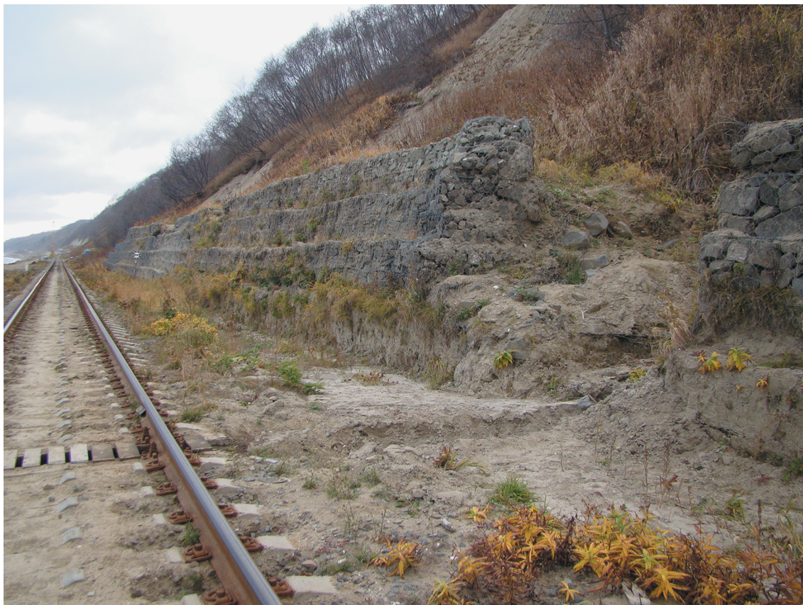
Рис. 1. Противооползневая подпорная стена, разрушенная склоновым селем.
